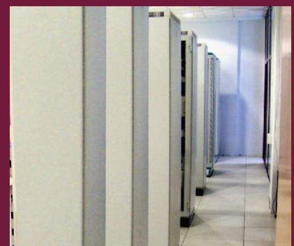
Vista del Data Center en nuestras instalaciones en Valencia.
